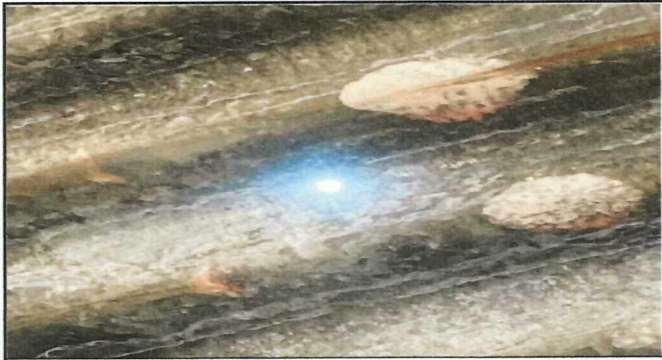
Foto 3: Se filtra el agua dentro de las aulas, situación que genera malestar y un ambiente inadecuado para el desarrollo de las clases.
