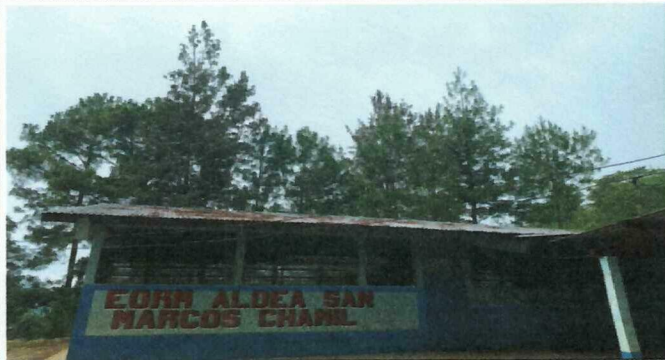
Foto 1: Cambio de techo, debido a que con el paso del tiempo se han agrietado las láminas.
