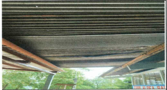
Foto 2: Mal estado de las láminas del corredor, provoca estancamiento de agua lo que genera la proliferación de insectos que causan enfermedades en los estudiantes.
